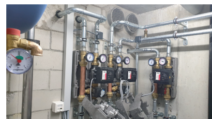
Heizungsverteiler über der Wärmepumpe (Leitungen noch ungedämmt)
